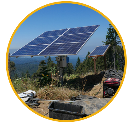
H. Solar Array
