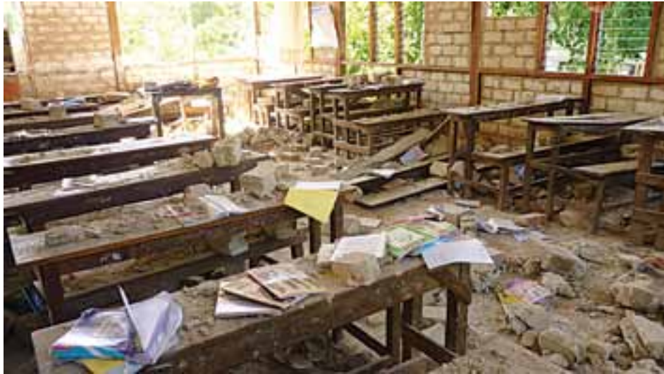
သပိတ်ကျင်းမြို့ရှိ ရွှေစင်ကြယ်ဘော်ဒါဆောင်ကို ငလျင်လှုပ်ပြီးနောက် တွေ့ရစဉ်
