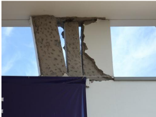
Imagen 52. Daños en pilares y muros tras el terremoto
