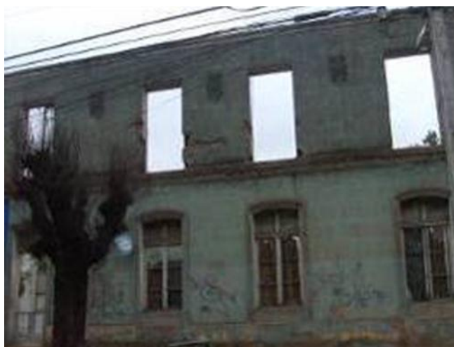
Imagen 22. Destrucción de viviendas, centro histórico de Talca
