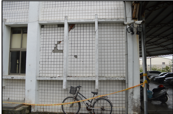
(d) Diagonal Wall Cracks Revealing assumed Hollow Clay Masonry.
